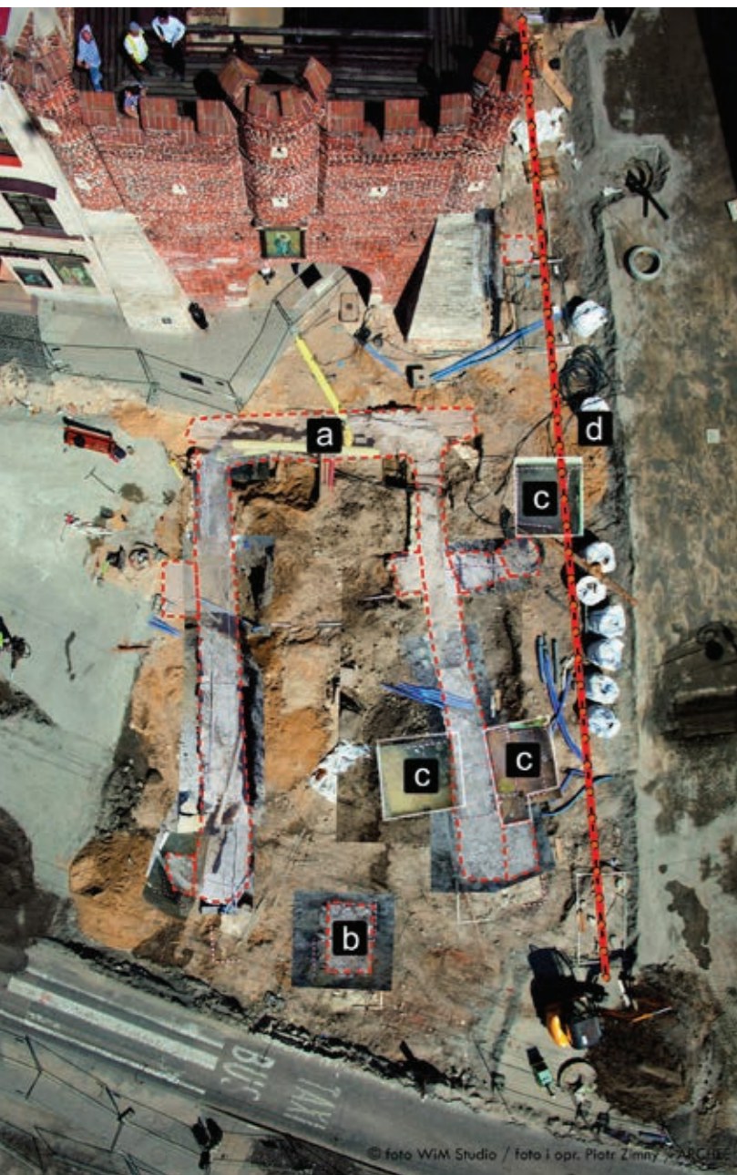
Barbakan podczas prac archeologicznych a – barbakan, b – filar środkowy barbakanu, c – wykopy archeologiczne, d – linia odwiertów sondujących fosę
